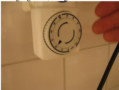
Fig 12. Kontrolltimer i läge drift
